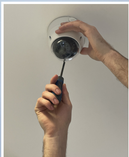
Des caméras ont aussi été posées à l'intérieur des halls d'immeubles.
